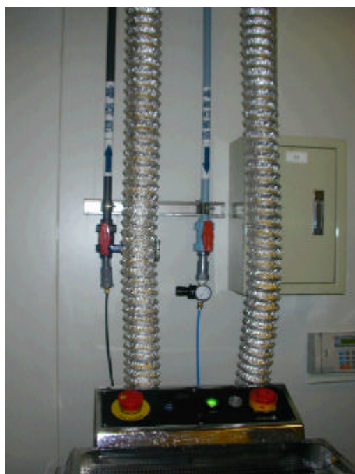
圖 3.13 機台連接之管路
